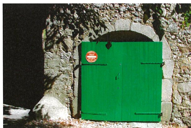
La pose d'un portail standardisé qui ne respecte pas la structure de l'ouverture
