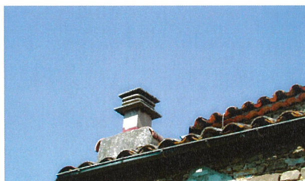
Mas Soubeyran. La structure initiale de la cheminée n'a pas été respectée
