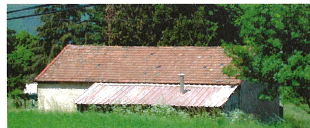
Secteur des Aigladines : tuiles plates et plaques ondulées métalliques sont à éviter
